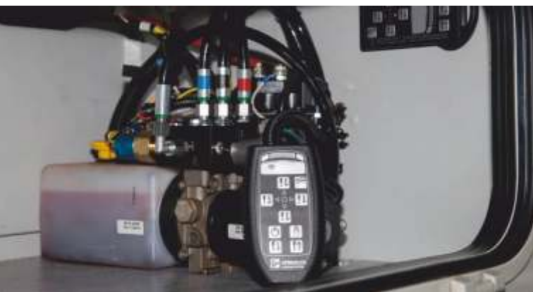
Pumpenblock mit Funkfernbedienung
